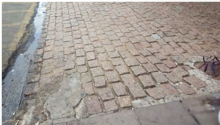
Figura 4: Rampa de acesso danificada- Rua D. Barros Cassal. Fonte: Dados de pesquisa, 2017.
